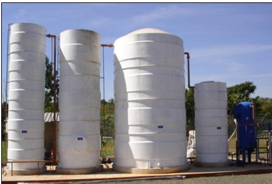
Figura 94 – Estação Compacta de Tratamento de Esgotos Sanitários.
