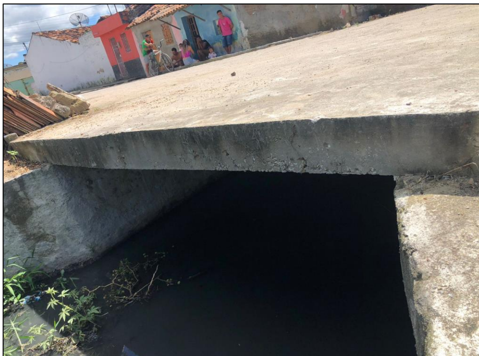
Figura 26 – Esgoto a céu aberto em Altinho.
